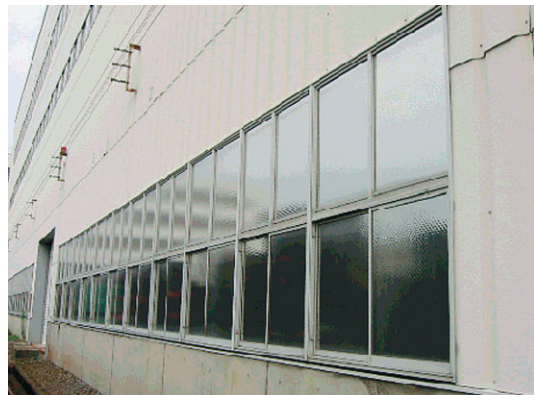
工場南面の窓ガラスに遮熱フィルムを貼付け（157m 2 ） 効果：CO 2 排出量を6%削減 29千kWh/年削減 3（t-C）/年削減
