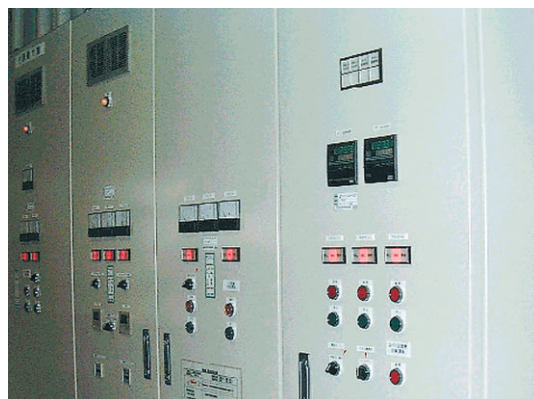
精密機械組立場の夜間・休日空調機停止スケジュール制御化 効果：CO 2 排出量を49%削減 317千kWh/年削減 31（t-C）/年削減
